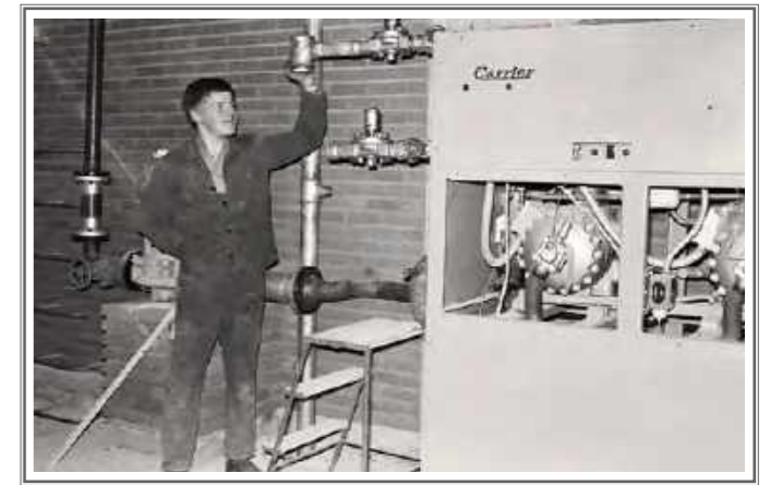
Mitarbeiter der Firma von Kurt Schiffer installierten im Jahr 1970 eine neue Heizungsanlage bei der Stadtparkasse in Odenkirchen.
